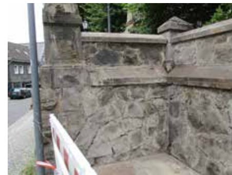
Übrig blieb die sanierungsbedürftige Mauer und Boden.
